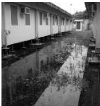
Figure 16. Rétenue d'eau par défaut de drainage après les pluies, Port-Gentil, Gabon. (© T. Coffinet)
